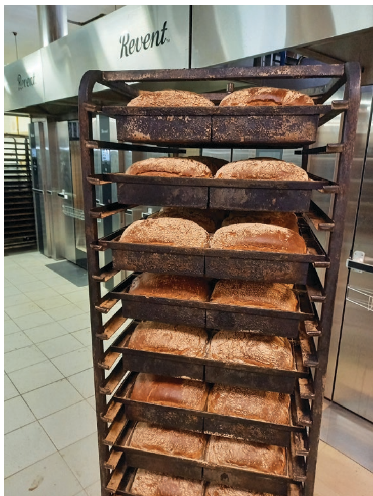
■ Wypiek chleba formowego i bułek wsad za wsadem – efekt: chrupka skórka i wilgotny miękisz (instalacja wjp. dolnośląskie).
